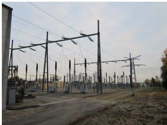
Photo 4 : exemple des parties visibles d'un poste
