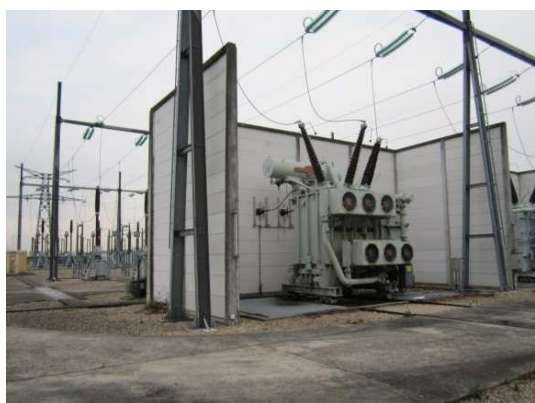
Photo 1 : exemple de Transformateur
