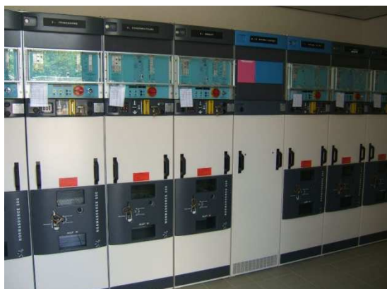
Photo 3 : exemple d'intérieur de bâtiment HTA
